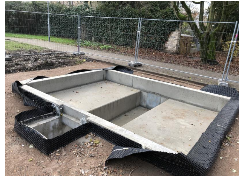
Fassungsvermögen ca. 2400 L
